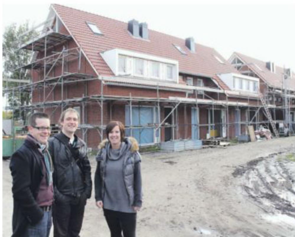
Vlnr: Rens Pallandt, Willem van Puijenbroek en Rafke Meulenbroeks bij de in aanbouw zijnde starterswoningen in Diessen.
